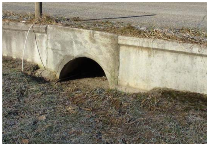
Die bestehende Amphibienunterführung ist nur etwa halb so gross, wie in den aktuellen Normen vorgesehen. Viele Tiere ziehen daran vorbei.
